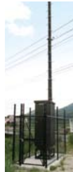
◀泉河内川(土師)に新しく設置しなおされたテレメータ(水位計)24時間、河川の水位を観測する。
