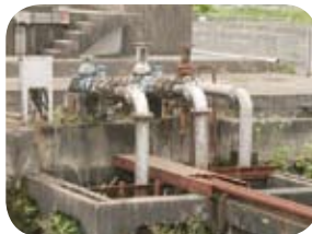
▲泉河内川の水を取水源とする土師浄水場の取水ポンプ
