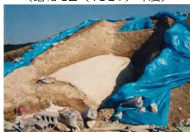
図 2-97：防水層の亀裂(平成 12 (2000) 年度)
