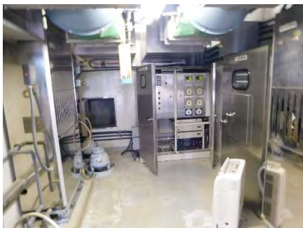
図 3-8：保存施設機械室
